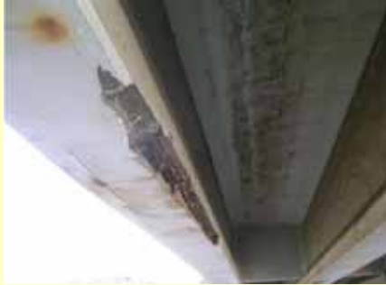
コンクリート橋(塩害)
