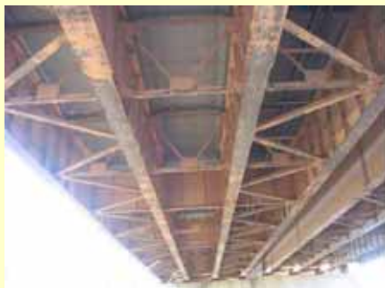
鋼主桁の塗装劣化
