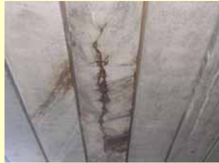
主桁のひび割れ
