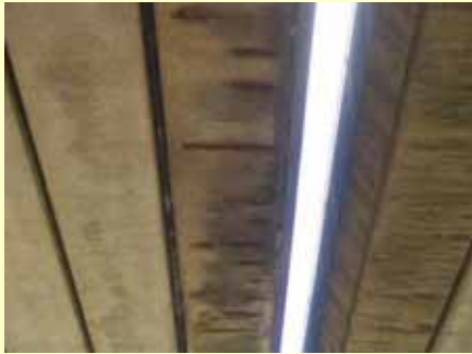
スターラップの腐食
