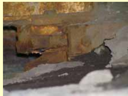
支承の腐食・土砂詰まり
